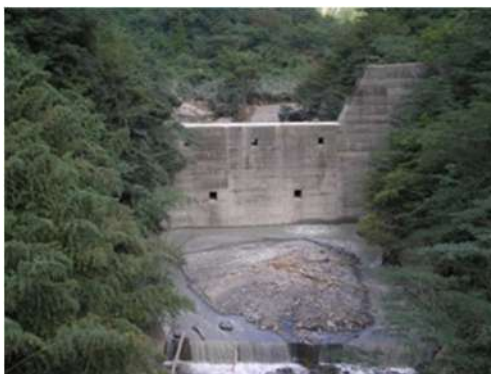
2005年14号台風の時に発生した 朴木ダムの濁水
