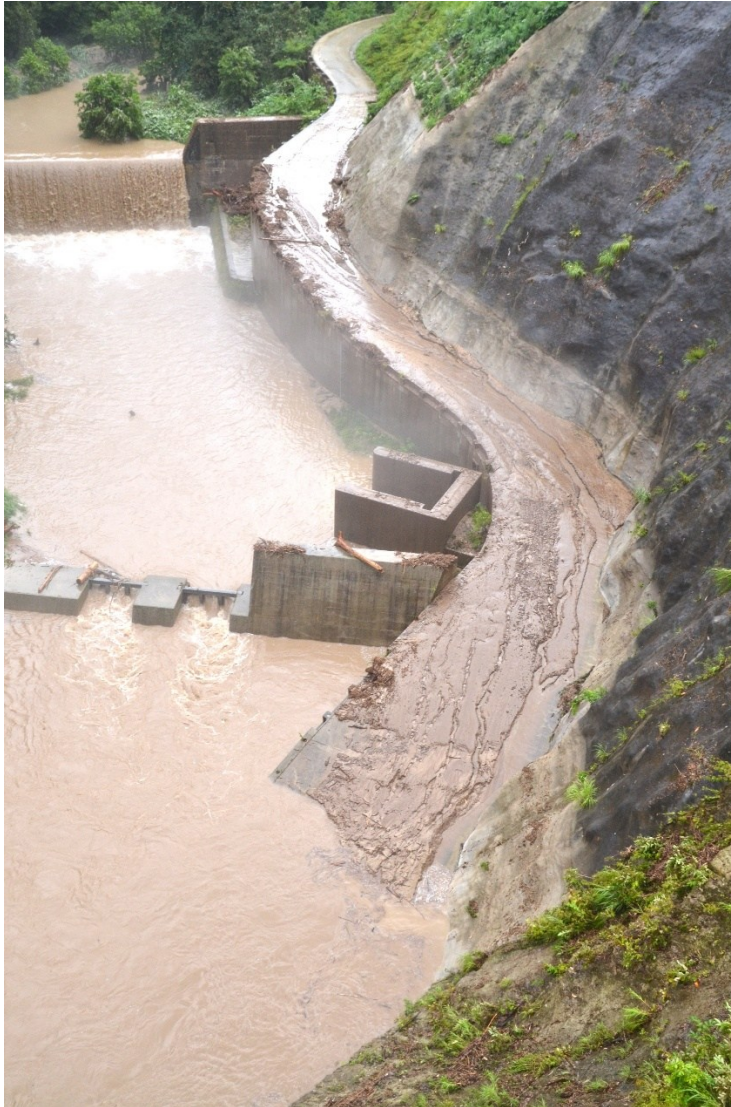
ダムの管理道路に溜まった泥
